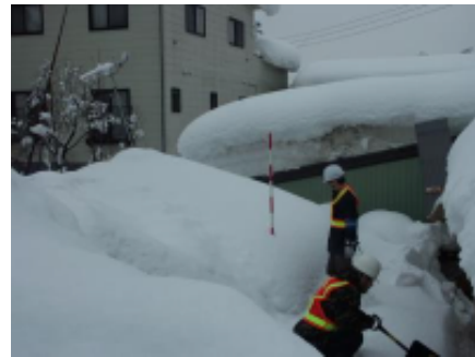
a) 倒壊家屋の近景。左下部分が倒壊した屋根部分。
